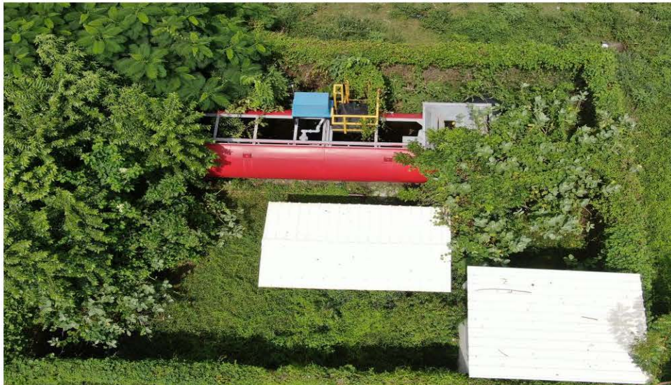
Foto 1. PTAR cubierta de vegetación y sin funcionar.
