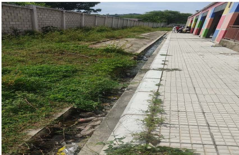
(Foto 2. Canaleta con aguas residuales estancadas y residuos sólidos ordinarios.)
